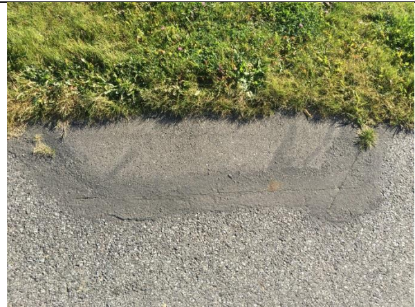
foto 4 Lap i asfaltbelægning hvor forsegling af revner ikke længere er tæt
