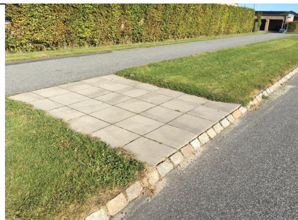
foto 6 Flisegang mellem vej og sti, med begyndende plantevækst i fuger
