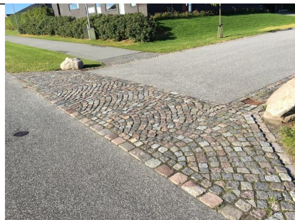
foto 5 Overkørsel i natursten med begyndende plantevækst i fuger
