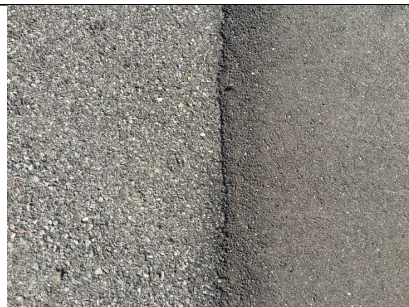
foto 11 Gammel og ny asfalt. Den gamle har lyst tilslag som den bør have pga. gadelys. Den nye asfalt er helt sort. Den gamle asfalt har en lidt åben overflade pga. nedbrydning, den nye er helt tæt.
