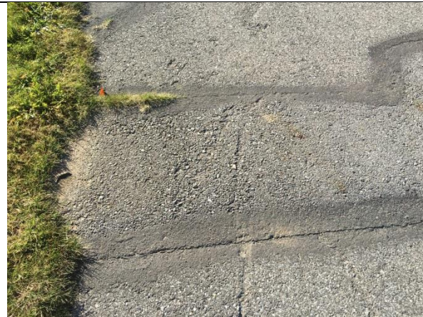
foto 3 Ledningsgrav hvor revnerne er åbne og der vokser græs
