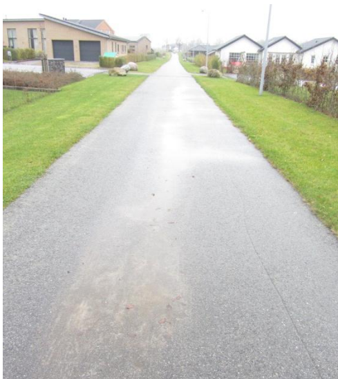
Billede 10 Lunker med vandansamling på sti
