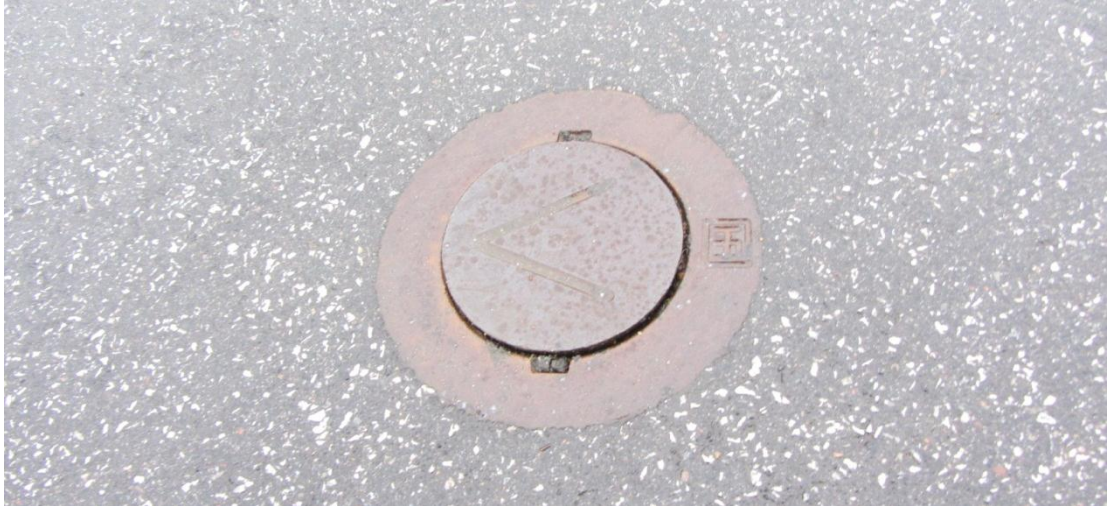
Billede 5 Eksempel på dæksel med asfaltrester i mellem karm og dæksel
