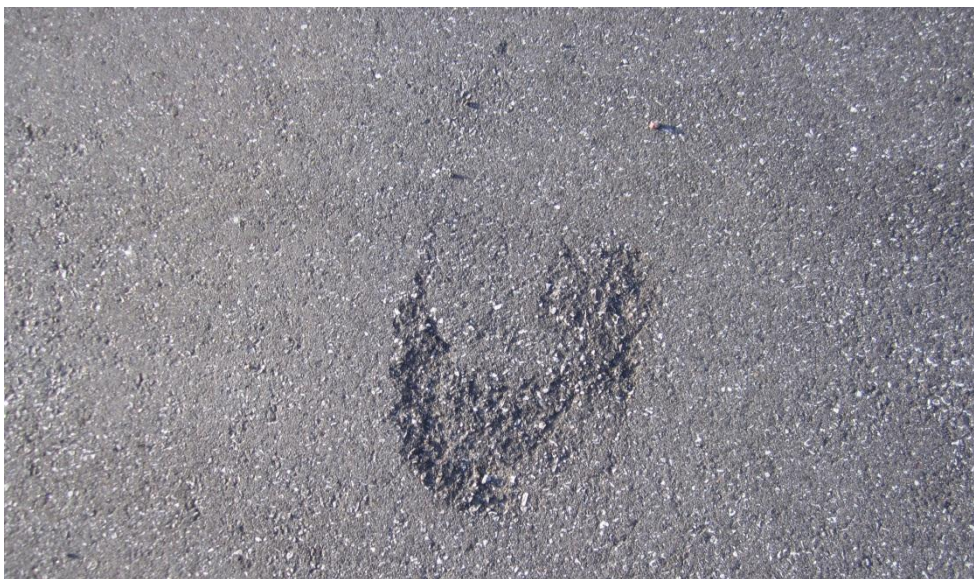
Billede 4 Vridning i belægningen
